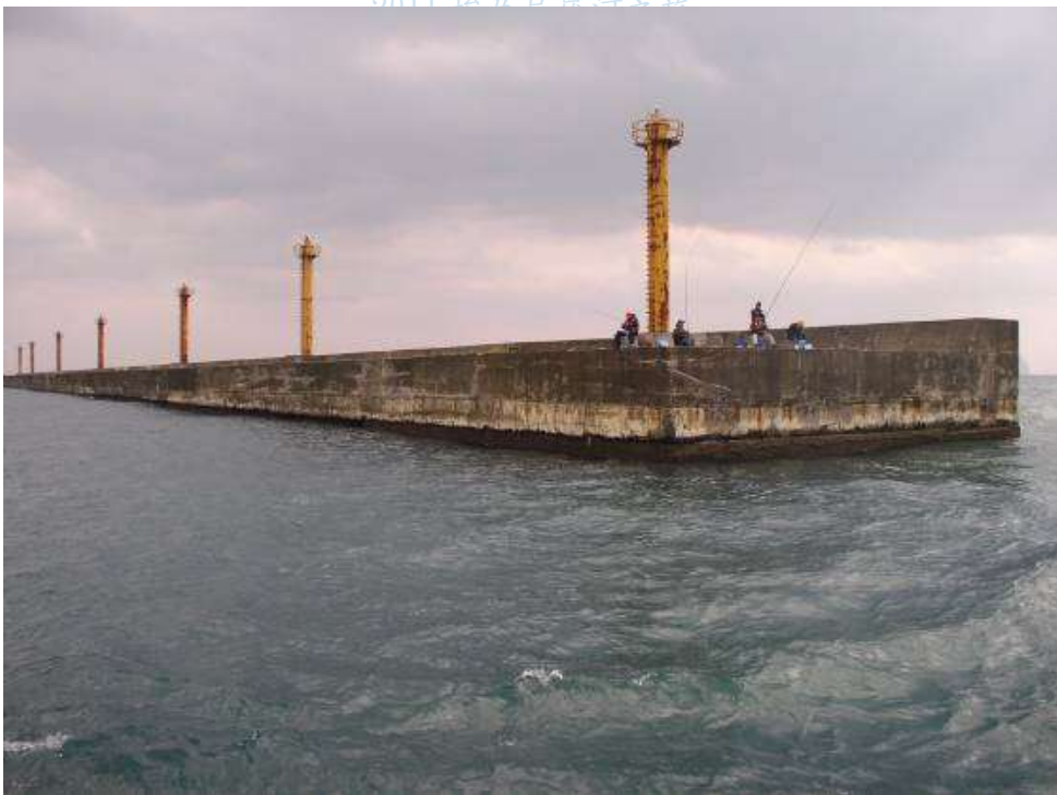
離岸堤 標誌燈(烏石漁港)
